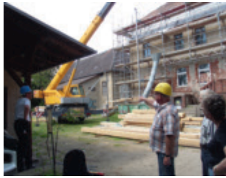
Oktober 2011: Die Erneuerung des Dachstuhls von über 600 m 2 . Eine Bauphase mit viel „großem Dreck“
